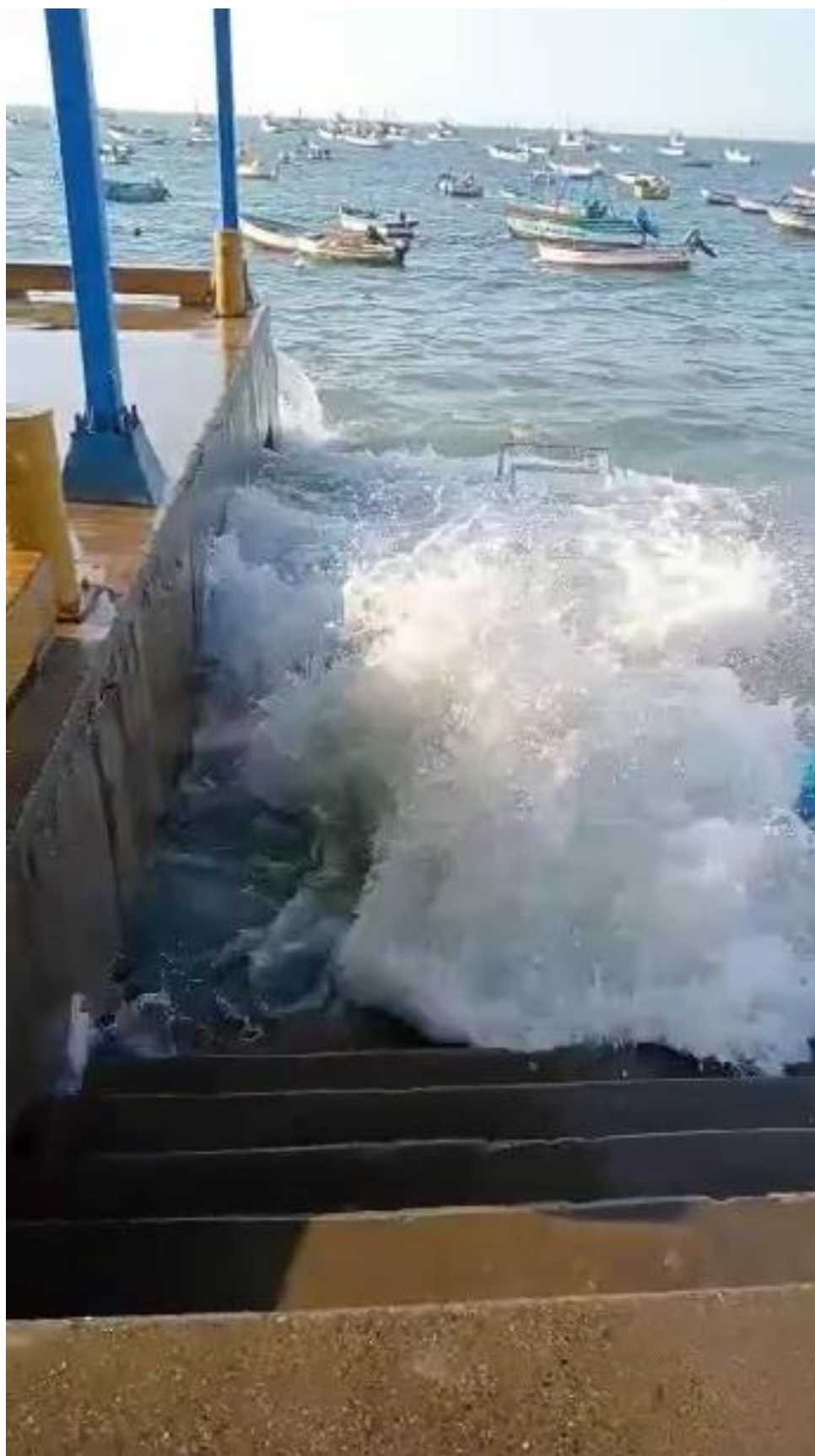
Foto N° 03: Afectación a la escalera en el DPA El Ñuro
