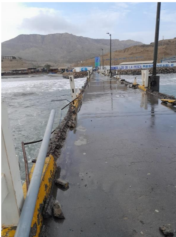
Foto N° 01: Afectación a Espigón en el DPA El Ñuro
