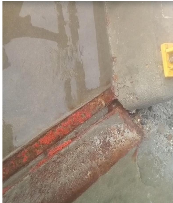
Foto N° 04: Afectación en el DPA Cabo Blanco
